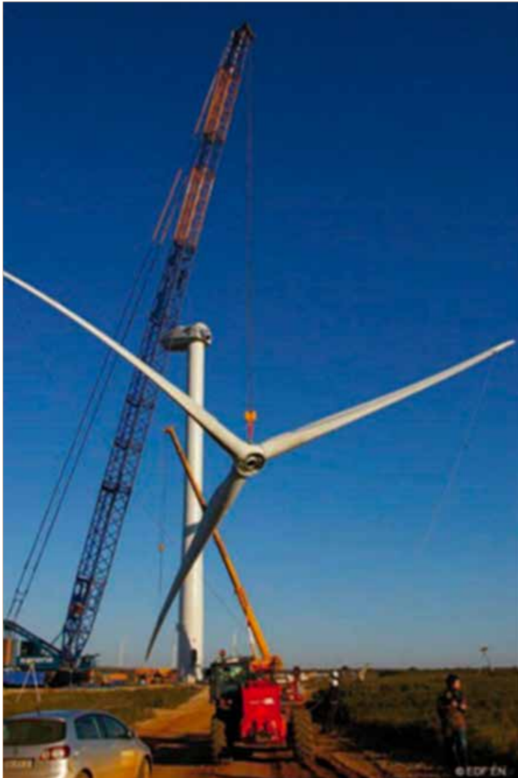
Exemple de montage du rotor
